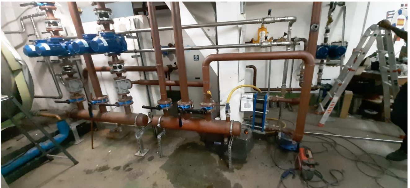
Detalle bombas circulación
