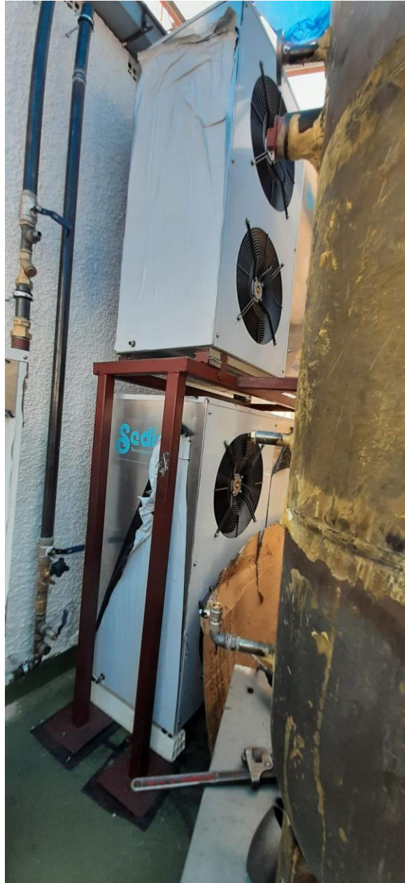
Detalle equipos Cubierta
