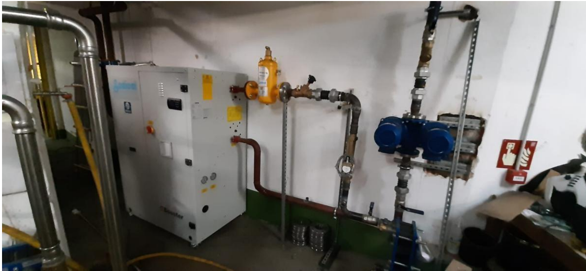
Detalle equipos sala (planta sótano)
